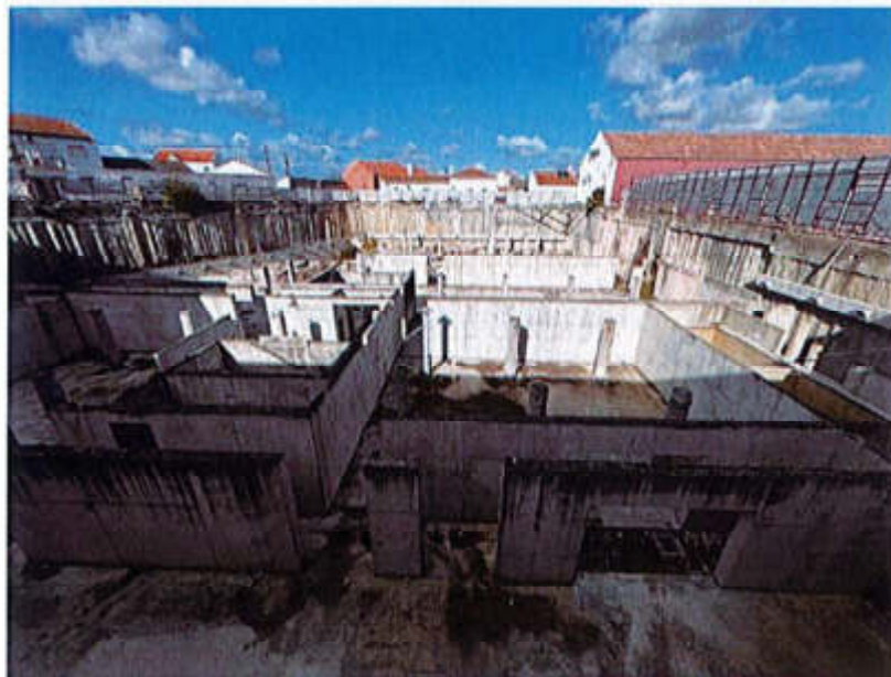
Figura 14 – Construção inacabada do hotel na Adega
